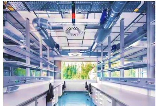
Bild 1: Lüftungsanlage eines Laborgebäudes
